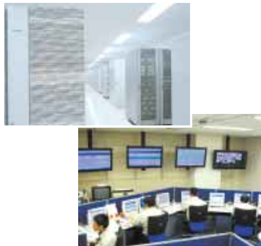
専門技術者が24時間365日、お客様のサーバを監視・運用する日立情報のデータセンター
