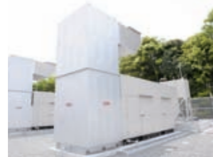
非常用自家発電設備
