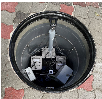
流量計室（内径 600mm）に設置した流量監視装置
