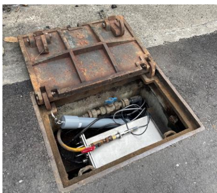
記録計室に設置した水圧監視装置
