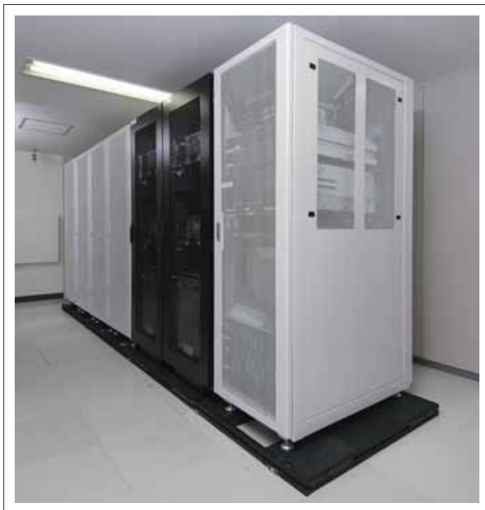
モジュール空間内に設置した IT 機器 (サーバラック等) とラック型冷却装置
