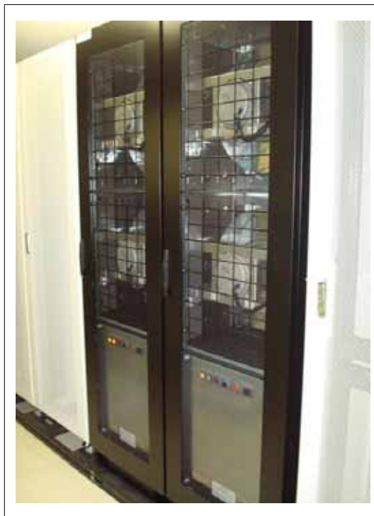
ラック型冷却装置のクローズアップ
